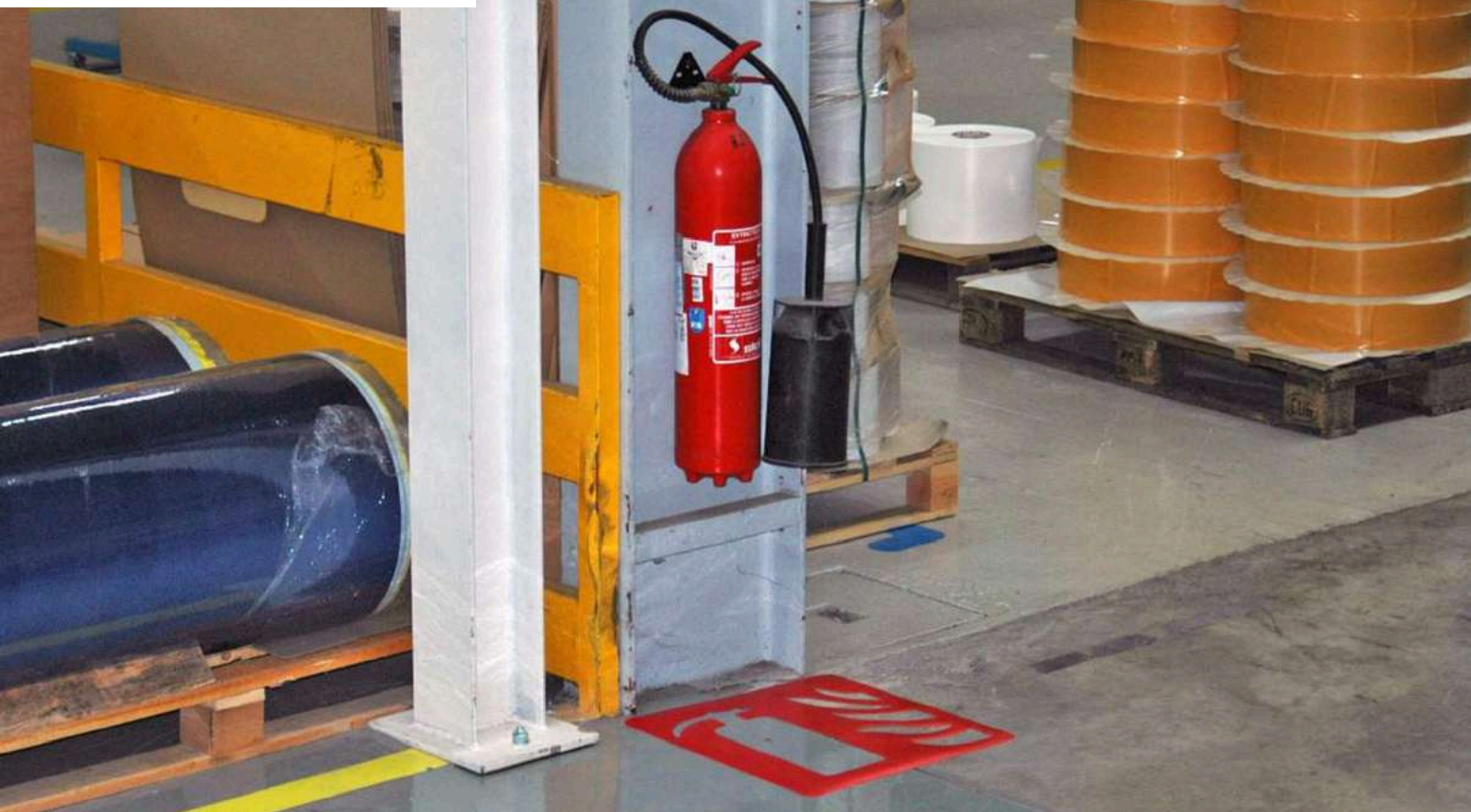
Signalisation des extincteurs
