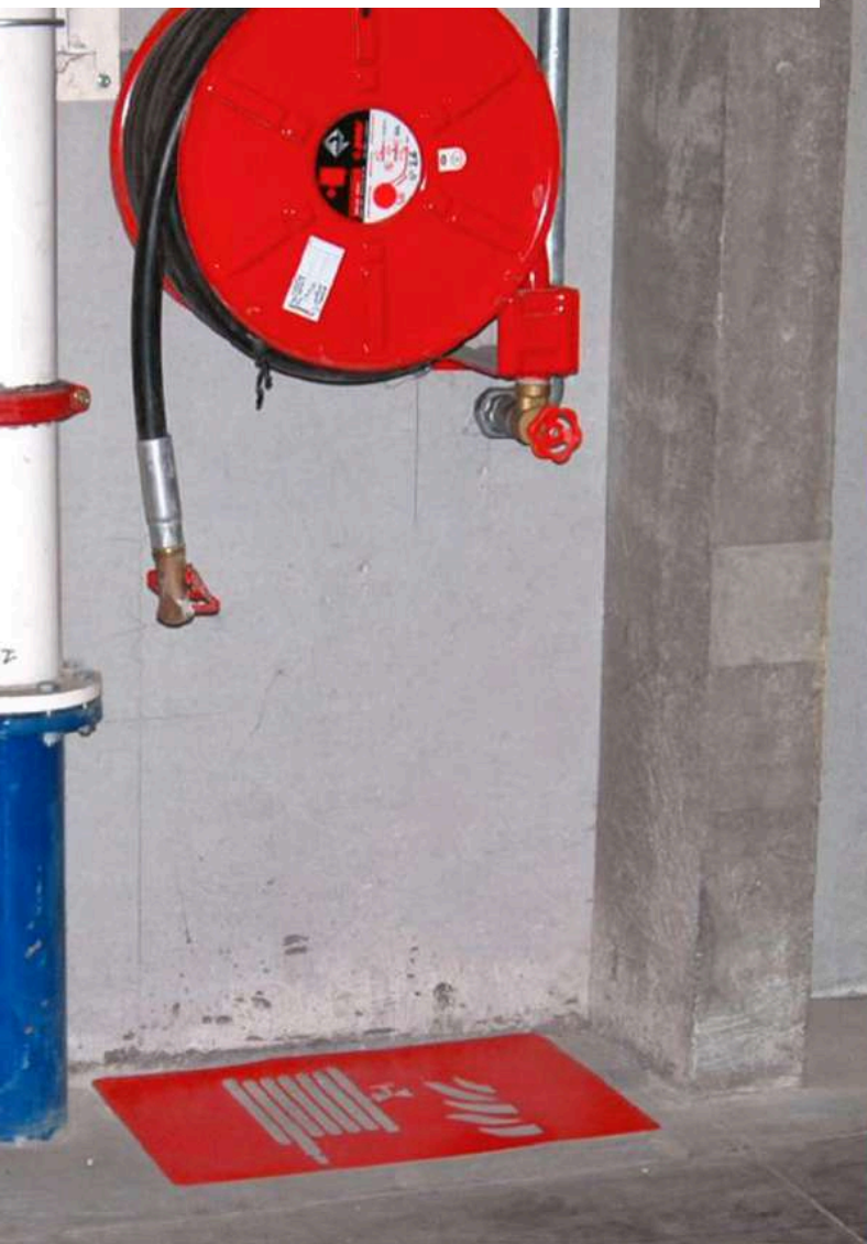
Signalisation des Robinets d'Incendie Armé
